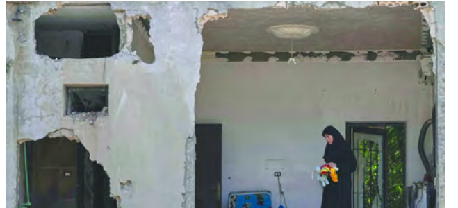
لبنانية تتفقد منزلها في بلدة عربصايم بعد تعرضه لقصف إسرائيلي
