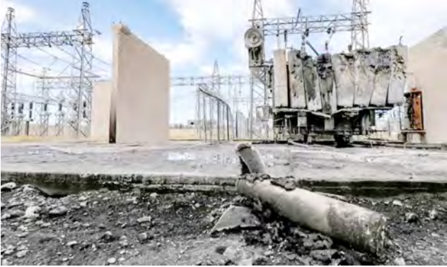
محطة كهرباء متفحمة جزاء سقوط صاروخ عليها
